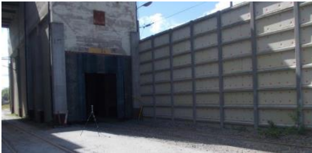
Figur 39. Norra öppningen. Bullerdämpande åtgärder: Uppbyggd bullerskärm mot nordväst samt ljuddämpande gummimattor i öppningen.
